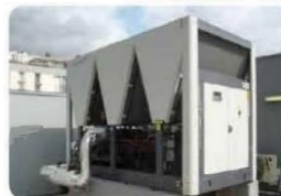
CHAUFFAGE ET CLIMATISATION
